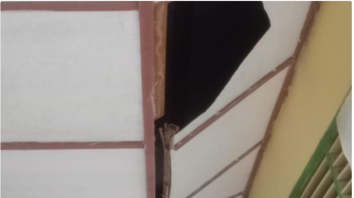
Foto: Plafon ruangan kelas UPTD SDN 67 yang rusak akibat angin kencang
